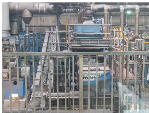
プラスチック破碎周辺設備
