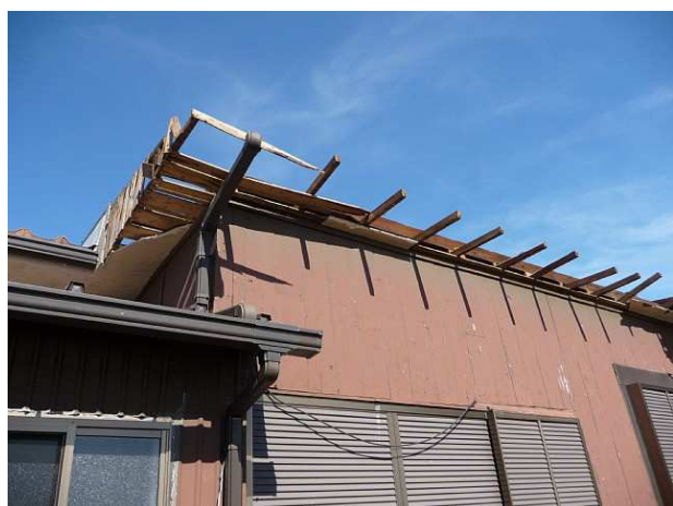
屋根が飛ばされた高田研修所(南側)
