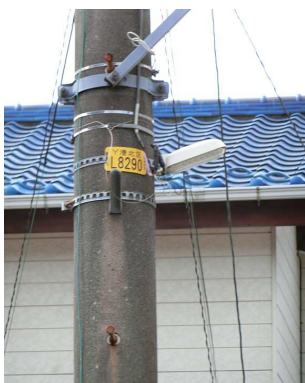
電柱共架型 LED 防犯灯
